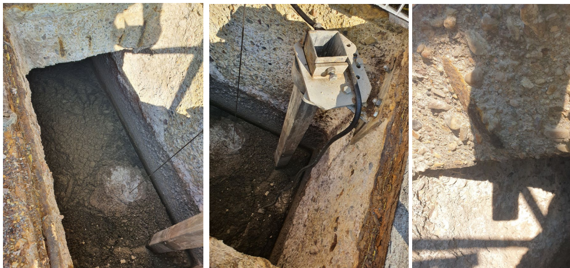
Fot. 2. Widok korozji w Zbiorniku Hydrolizy
