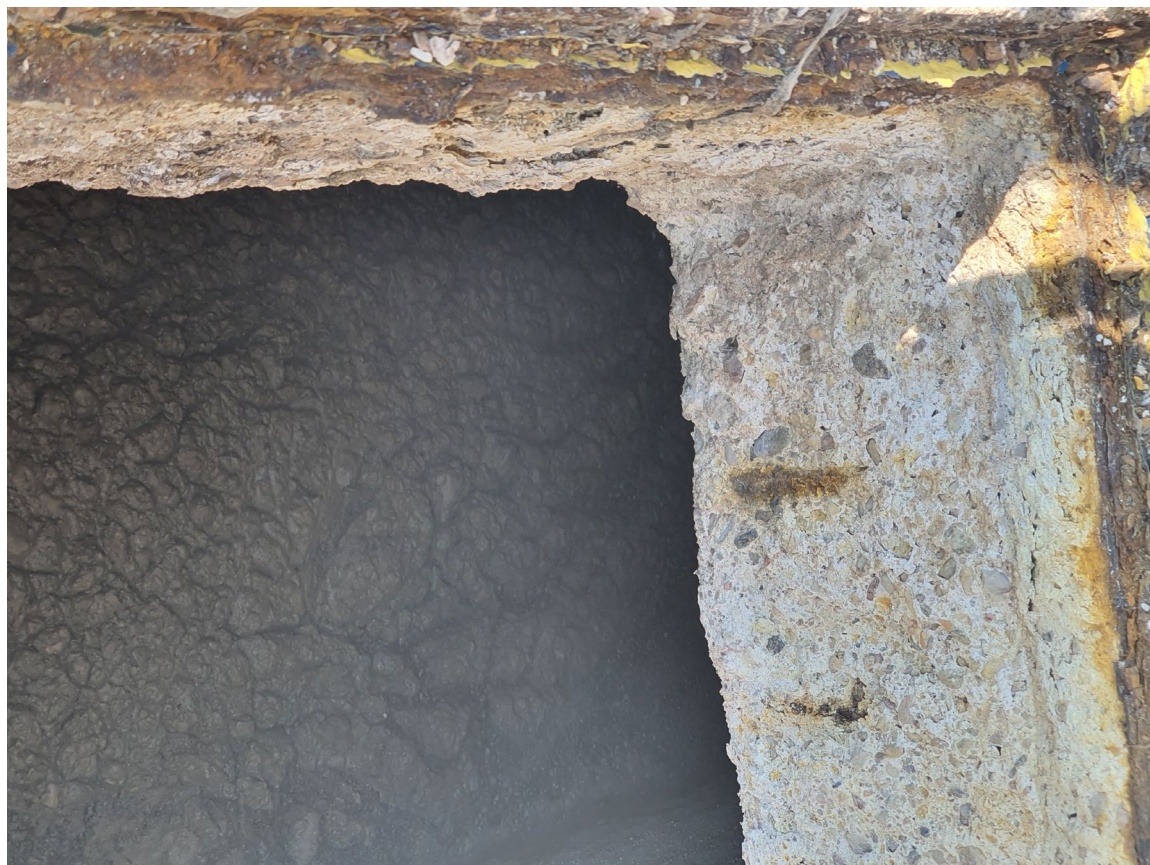
Fot. 3. Widok korozji w Zbiorniku Hydrolizy
