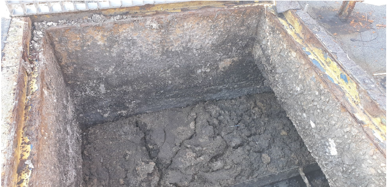
Fot. 4. Widok korozji w Zbiorniku Zagęszczacza
