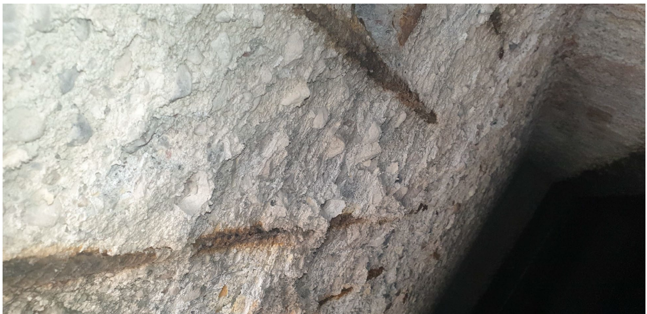
Fot. 5. Widok korozji w Zbiorniku Zagęszczacza (strop)
